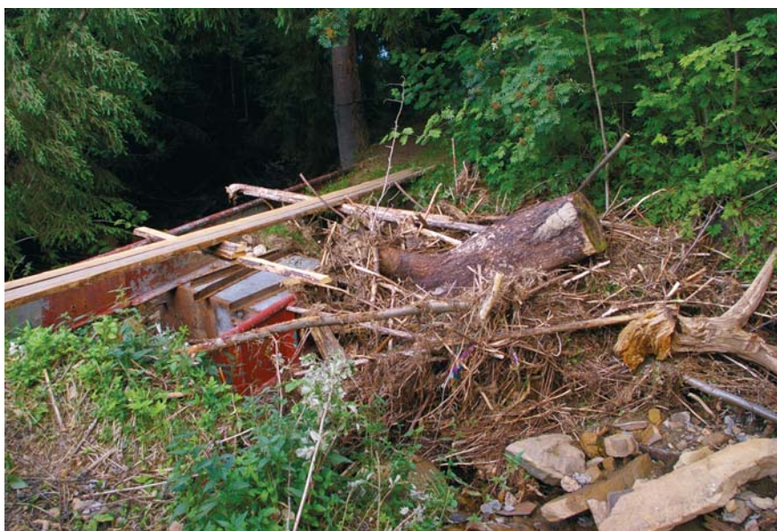
Fot. 5. Zablockowany przepust drogowy i zniszczony mostek – Chrobaków potok Blocked road culvert and damaged bridge – over the Chrobaków stream
