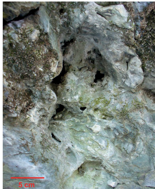
Ryc. 5. Pustki krasowe na ścianie skałki A – efekty rozpuszczania fragmentów skały zbudowanych z węgla wapnia (27.11.2015 r., fot. A. Michniewicz)
