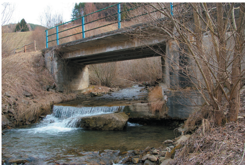
Fot. 14. Podmyty filar mostu w korycie potoku Jamne Washed out bridge pier in the Jamne stream
