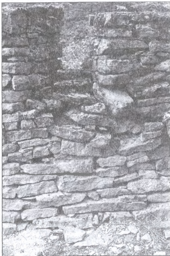
Fig. 7. Dracy (Côte d'Or), village. L'ouverture A 1 dans le mur oriental du bâtiment XII.
