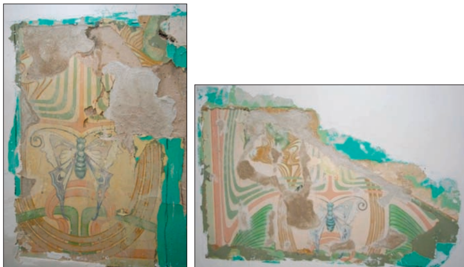
Fot. 17, 18. Odkrytki wymalowań ścian klatki schodowej zabytkowego budynku przy pl. Bema 3 w Olsztynie (wyk. E. Doleżyńska-Sewerniak).
