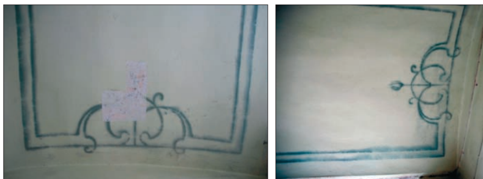
Fot. 9, 10. Świadek występowania złoceń sufitu klatki schodowej zabytkowego budynku przy ul. Wojska Polskiego 60 w Olsztynie (wyk. E. Doleżyńska-Sewerniak)
