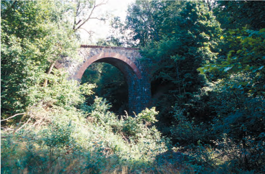
Fot. 29. Dobrze zachowany kamiennie-ceglany most przez Radew na rozebranej przez Armię Czerwoną normalnotorowej linii Bobolice–Polanów
