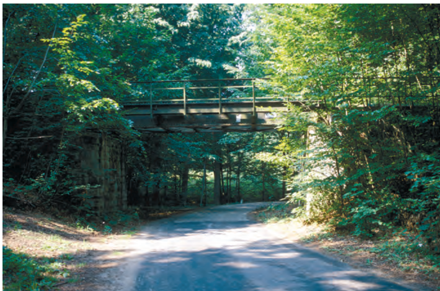
Fot. 58. Wiadukt kolejowy koło miejscowości Tardy na rozebranej w 1998 r. normalnotorowej linii Morağ–Miłomłyn
