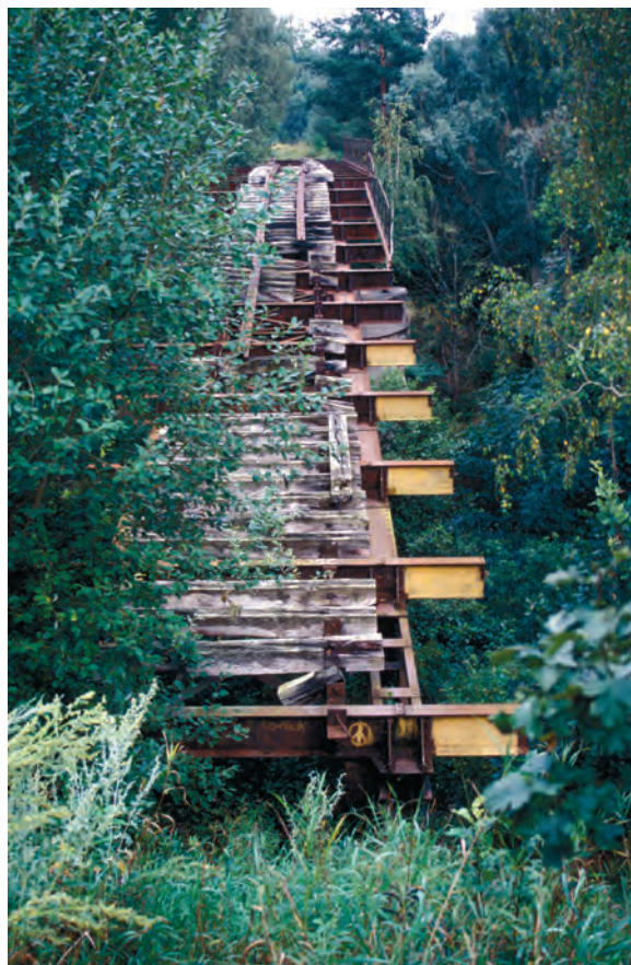
Fot. 31. Pozostałości zrujnowanego mostu przez Gwdę koło Płytnicy na rozebranej przez Armię Czerwoną normalnotorowej linii Wałcz–Węgierce
