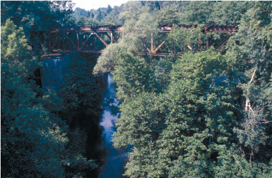
Fot. 33. Zrujnowany most przez Pasłękę koło Ornety na rozebranej przez Armię Czerwoną normalnotorowej linii Orneta–Morąg
