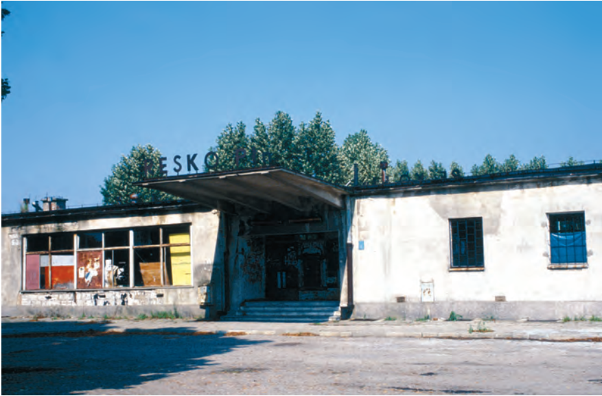
Fot. 63. Przykład całkowicie zdewastowanego dworca w Resku Północnym, z którym ostatnie połączenia zamknięto formalnie dopiero w latach 1990.
