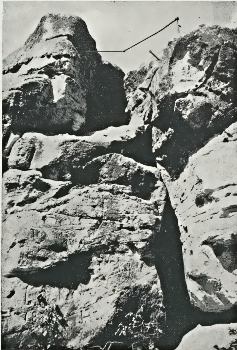
Ryc. 15. Poszerzona szczelina służąca jako wyjście na szczyt Skałki z Krzyżem. Na ścianach widoczne ślady niszczenia
