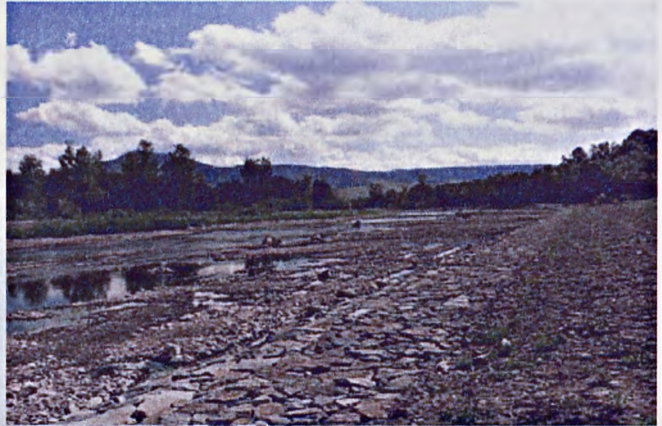
Fot.5.3. Skanalizowany odcinek Raby w okolicy Pcimia. Channelised river stretch near Pcim village.
